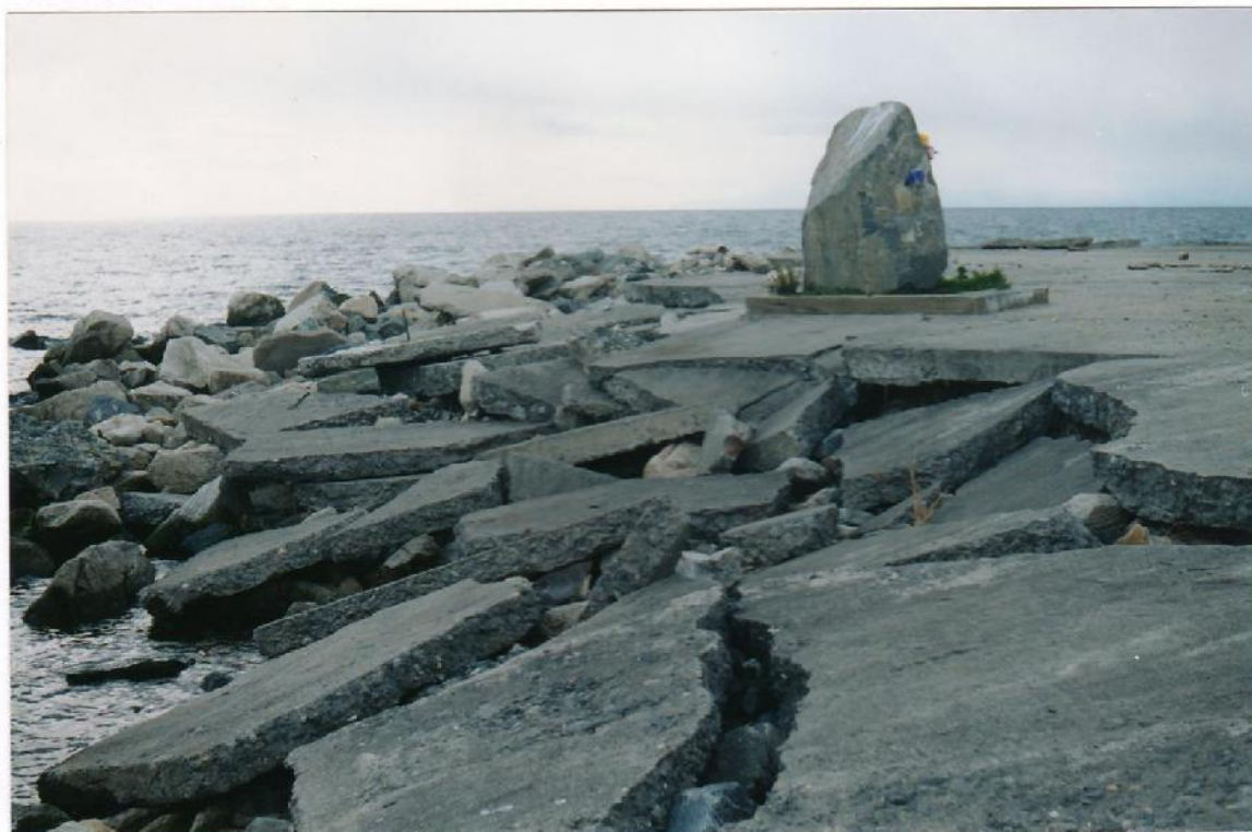
Рисунок 2 - Разрушение бетонной плиты в головной части оградительно мола (Октябрь 2004 г.)
